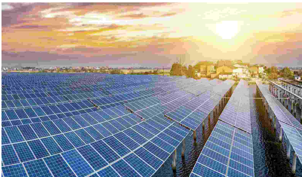
➔ I pannelli fotovoltaici sono tra gli ambiti di intervento Fesr
